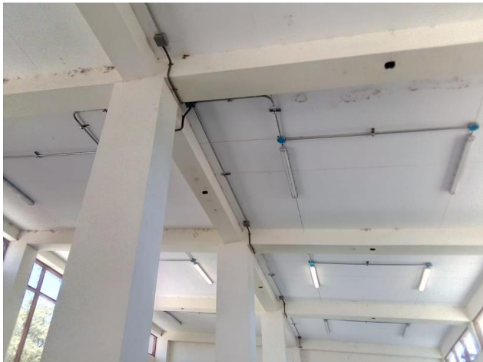
INSTALACION DE LUNINARIAS, TUBERIAS, CAJAS ELECTRICAS EN LA ZONA DE TAREAS PREVIAS
