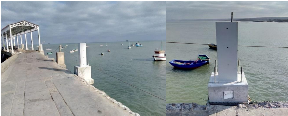
PEDESTALES PARA LUMINARIAS EN PUENTE Nº2
